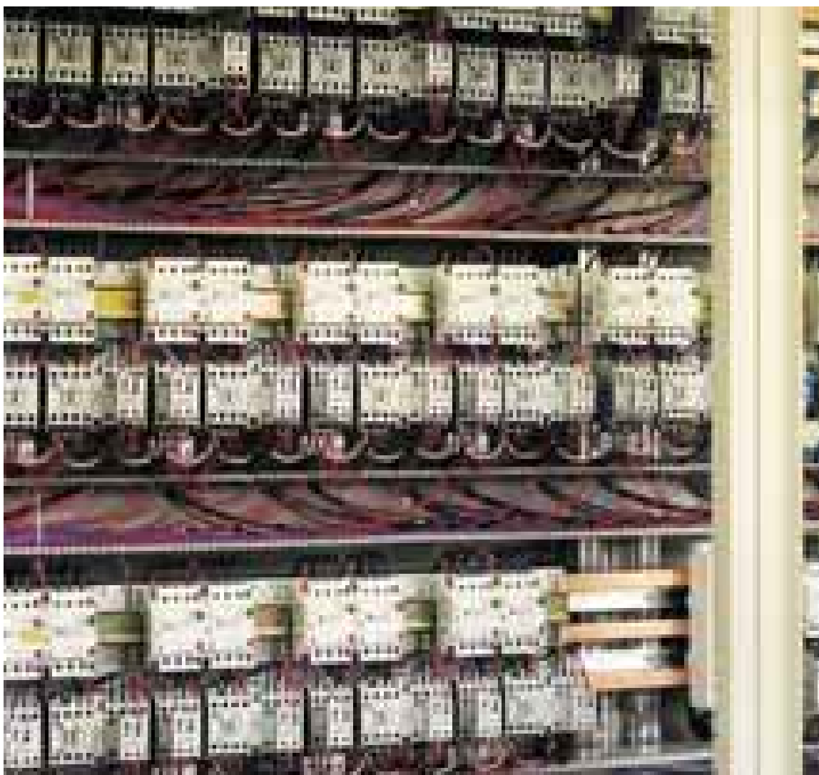
Vue intérieure d'une armoire électrique à l'usine de traitement des eaux usées: le Modular Control System (MSC) a été le premier choix pour les éléments de distribution de puissance compacts et bien conçus.
