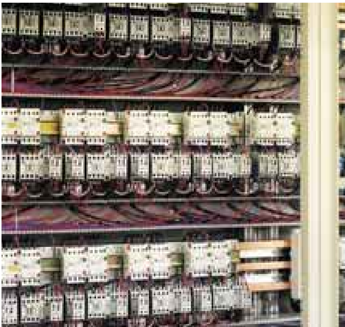
Veduta interna dell'armadietto delle apparecchiature di comando dell'impianto di trattamento delle acque di rifiuto: il sistema modulare di controllo ha rappresentato una scelta ottimale per compattare alimentatori elettrici ben progettati.
