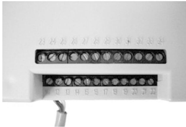
Figura 3: Terminais de controle do controlador SMC-Flex
