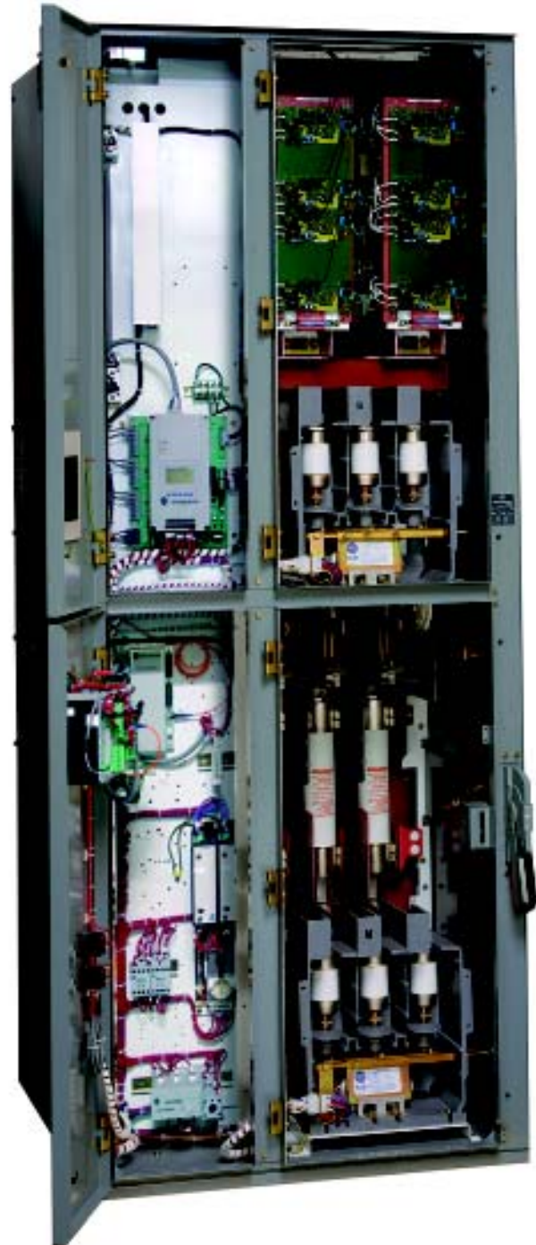
Bulletin 1562E Softstarter komplett mit Eingangsfeld (Eingangstrenner, Sicherung und Vakuumschutz)
