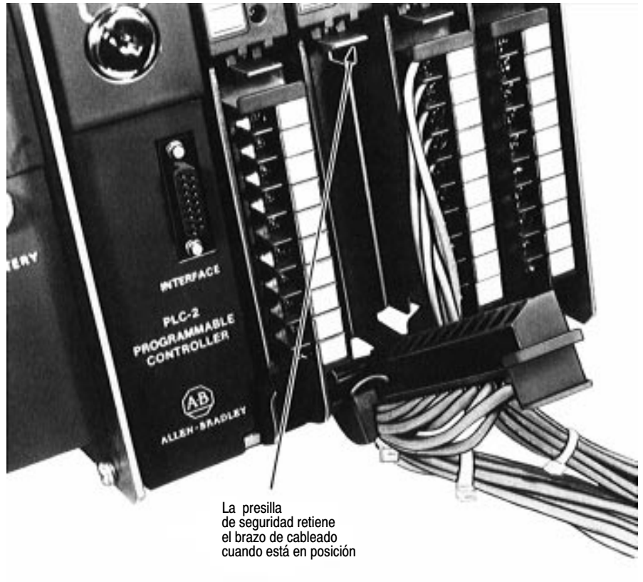
Figura 5 Brazo de cableado de campo instalado
